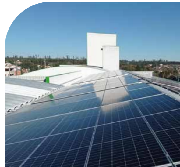
En la planta de Santa Comba Dão (Portugal) se ha instalado una unidad de producción con 362 paneles fotovoltaicos de 550 Wp cada uno.
